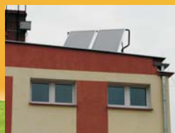
Panele solarne na Szkole w Stołcznie
